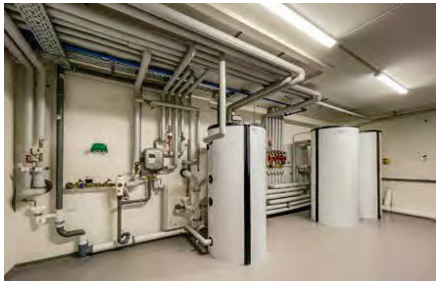
Für die weitere Versorgung wurden in den einzelnen Hallen jeweils eigene Pufferspeicher mit 1 000 bzw. 800 l Fassungsvermögen installiert.
