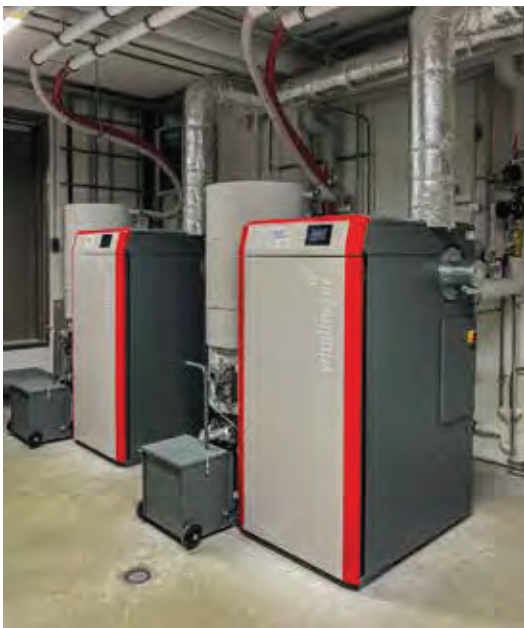
Im Heizhaus sind die beiden in Kaskade geschalteten PuroWIN Pellets-Kessel mit je 100 kW Nennleistung untergebracht sowie die beiden Pufferspeicher mit je 3 000 l Volumen.
